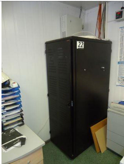
№ п/п 46, инв. № 22, Сервер 22 - установлен в кабинете инженера энергетика - мет. шкаф с телеком. оборудованием
