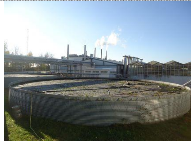
№ п/п 41, инв. № 36, Резервуар дождевой воды.
