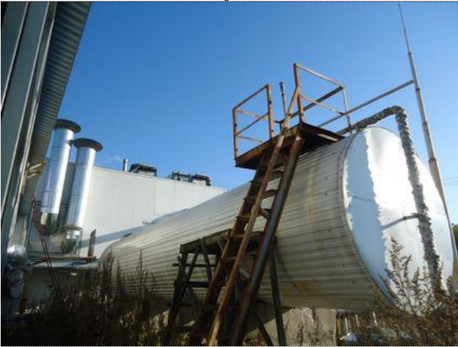
№ п/п 40, инв. № 35, Резервуар для дизтоплива.
