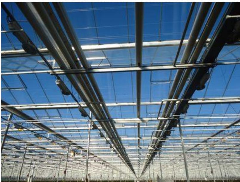
Система отопления в тепличном комплексе №1
