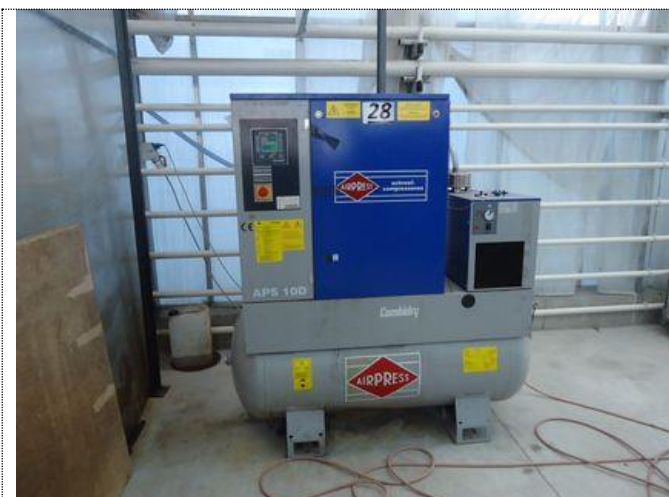
№ п/п 2, инв. № 28, Аппарат высокого давления - воздушный компрессор Combidry APS 10D, 2008 года выпуска
